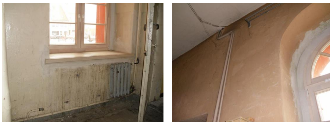
Zdjęcie 2. Pomieszczenia Ratusza wymagające rewitalizacji – stan techniczny [Źródło: Urząd Miejski w Grodkowie]
